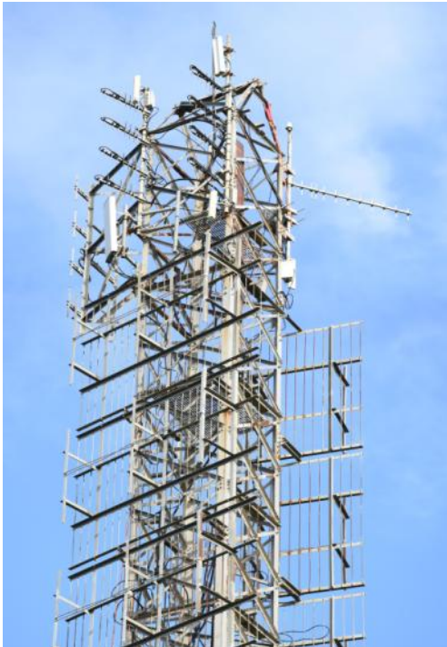
Klondyke Upper Mast
